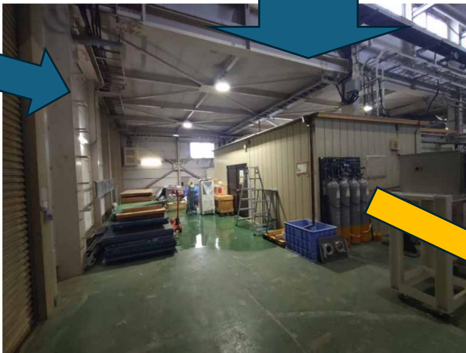
天井段差のところからかなりの漏水
